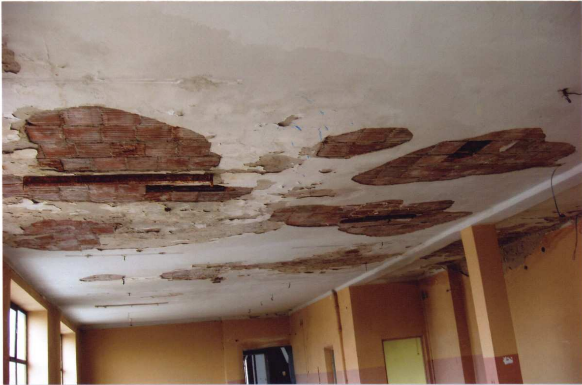
Nr 19. Pomieszczenie sklepu na piętrze budynku "N". Od zacieków stropu nad pięciem odpada tynk. Odsłonięte zostały pręty zbrojeniowe stropu Akermana.
