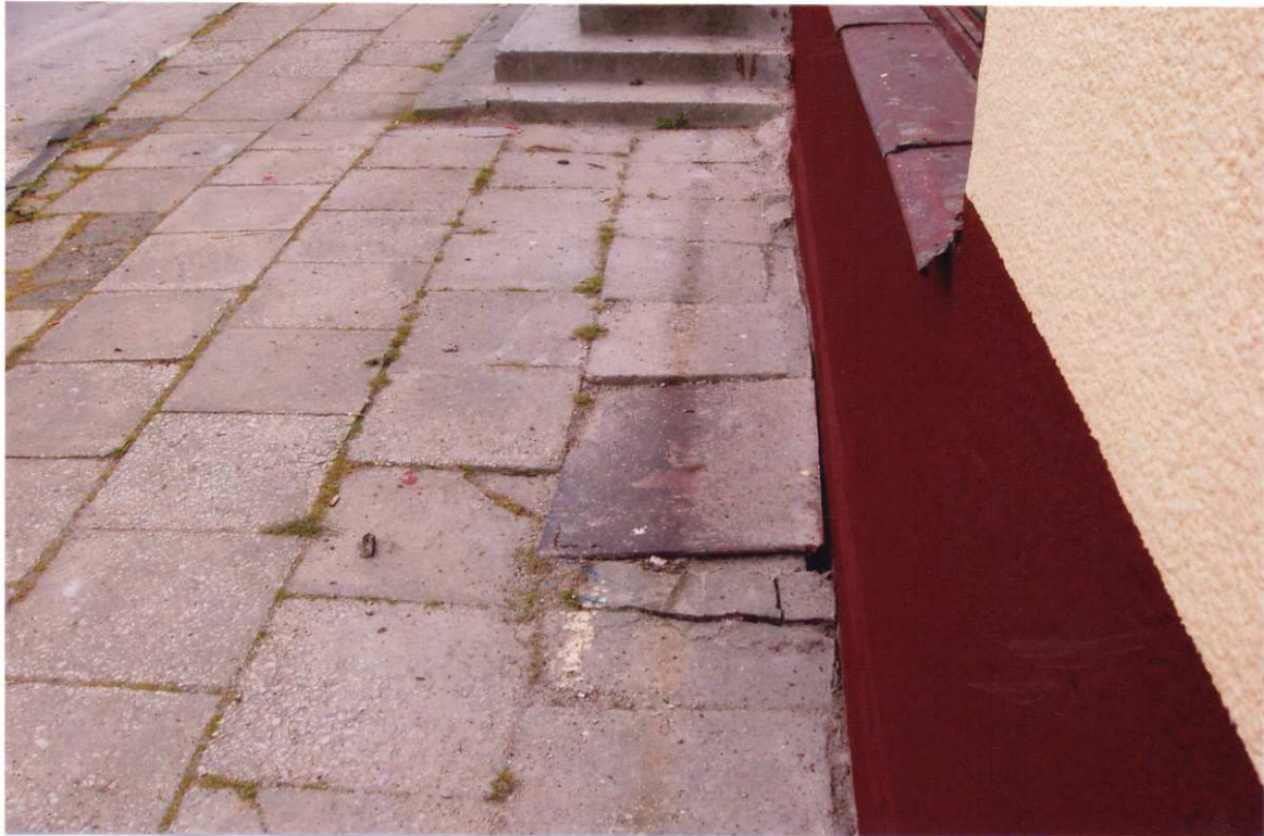
Nr 29. Prowizoryczne i nieszczelne nakrycie szachtu powoduje zalewanie szachtu i piwnicy.
