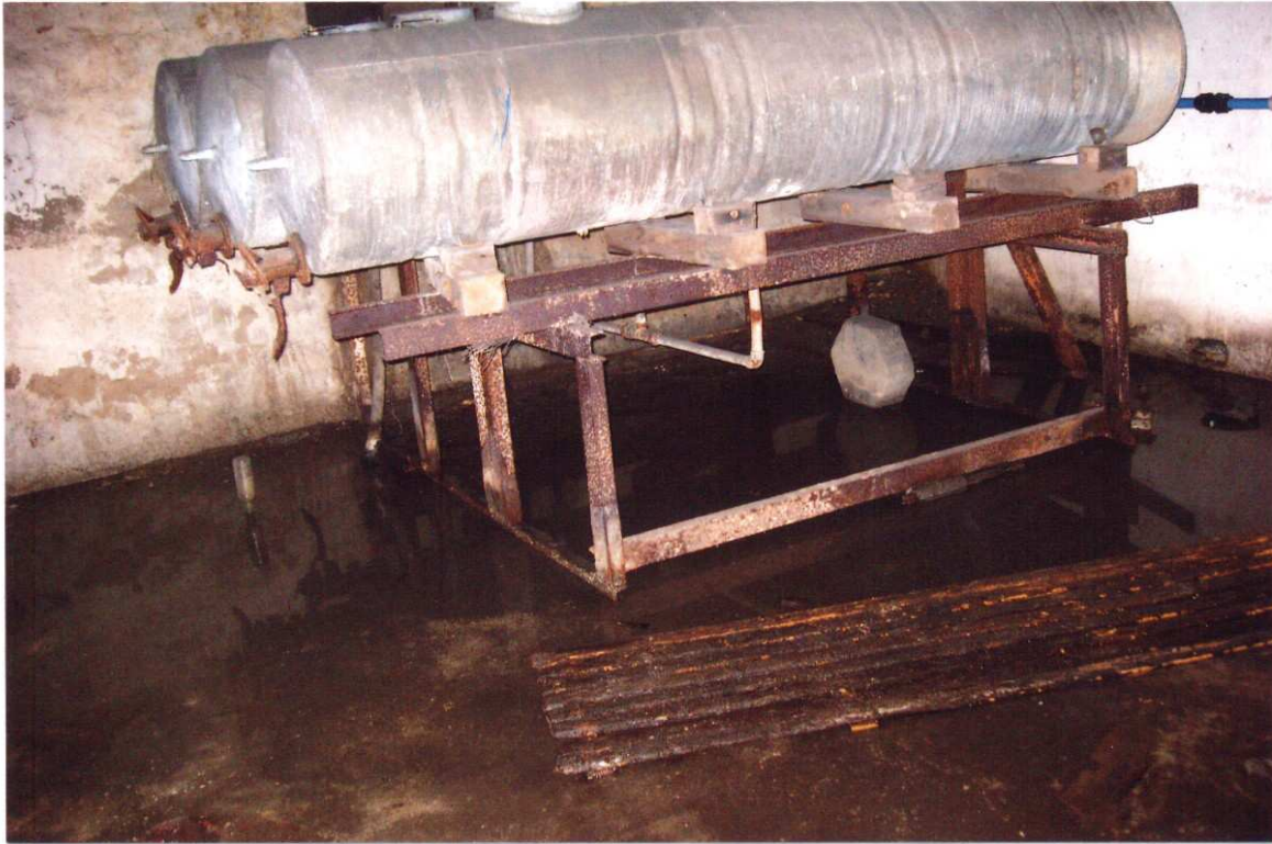
Nr 23. Widok zalanego pomieszczenia piwnicznego.
