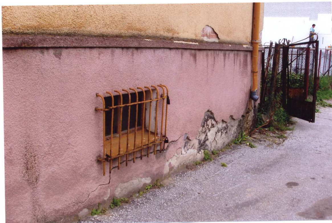
Nr 32. Widok odpadającego tynku na cokole narożnika południowo-wschodniego zalewanego przez spadającą wodę z rury spustowej.
