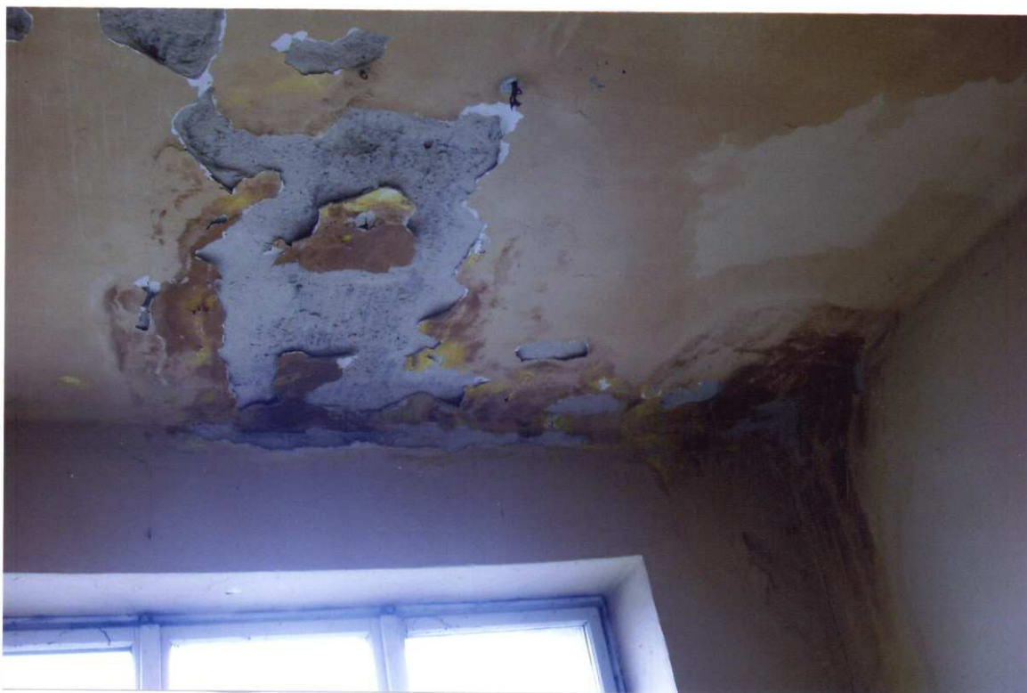
Nr 21. Widok zacieku stropu w narożniku sklepu budynku "R". Obok złuszczone odpadająca warstwa malowania stropu.
