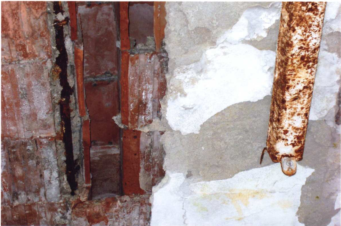
Nr 20. Strop Akermana nad pięciem sklepu w budynku "N". Widok odsłoniętego zbrojenia stropu, dolna część pustaka odpadła. Obok skorodowana lampa. Na tynku stropu widoczne ślady przecieku stropu.
