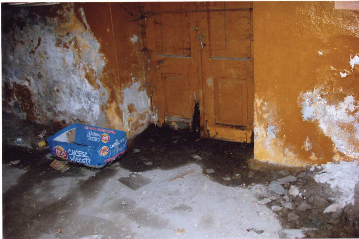
Nr 24. Widok ściany zachodniej piwnicy pod restauracją w budynku "N". Widoczne jest zalewanie wodą opadową piwnic przez istniejące drzwi. Na zawilgoconych ścianach łuszczy się i odpada farba . Część posadzki piwnicznej jest nie zalana wodą. Jest to ewidentny dowód pochodzenia znajdującej się wody w piwnicy !!!.
