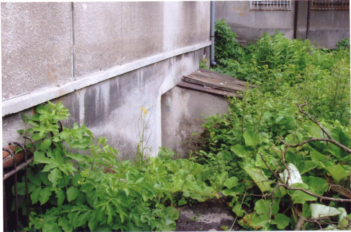
Nr 25. Zarośnięte zewnętrzne wejście do piwnicy od strony podwórza. Obok prowizoryczne nieszczelne nakrycie wyciągu żużla z kotłowni.
