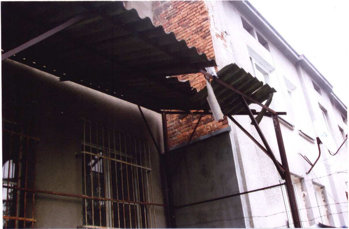
Nr 27. Zniszczone zadaszenie nad schodami wejściowymi do piwnicy budynku "R". Woda deszczowa ze złamanych płyt eternitu falistego kierowana jest bezpośrednio do wejścia do piwnicy.
