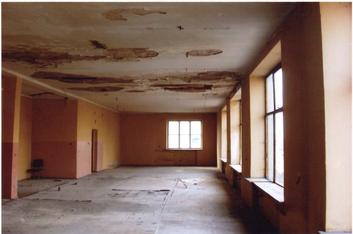
Nr 18. Widok pomieszczenia sklepu na piętrze budynku "N". Na stropie widoczne miejsca odpadnięcia tynków.
