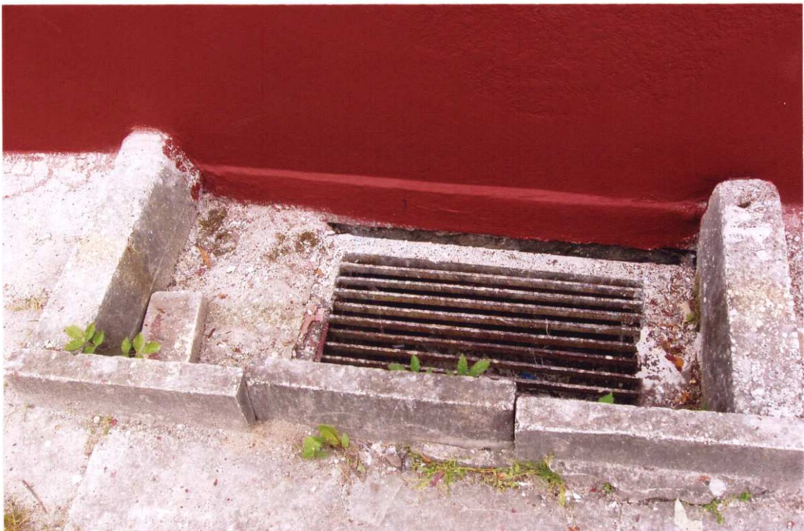
Nr 28. Widok szachtu okna piwnicznego budynku "R" przy ul. Rynek. W szachcie zalega gruz, którego spadek powierzchni kieruje wodę bezpośrednio do okna piwnicznego.
