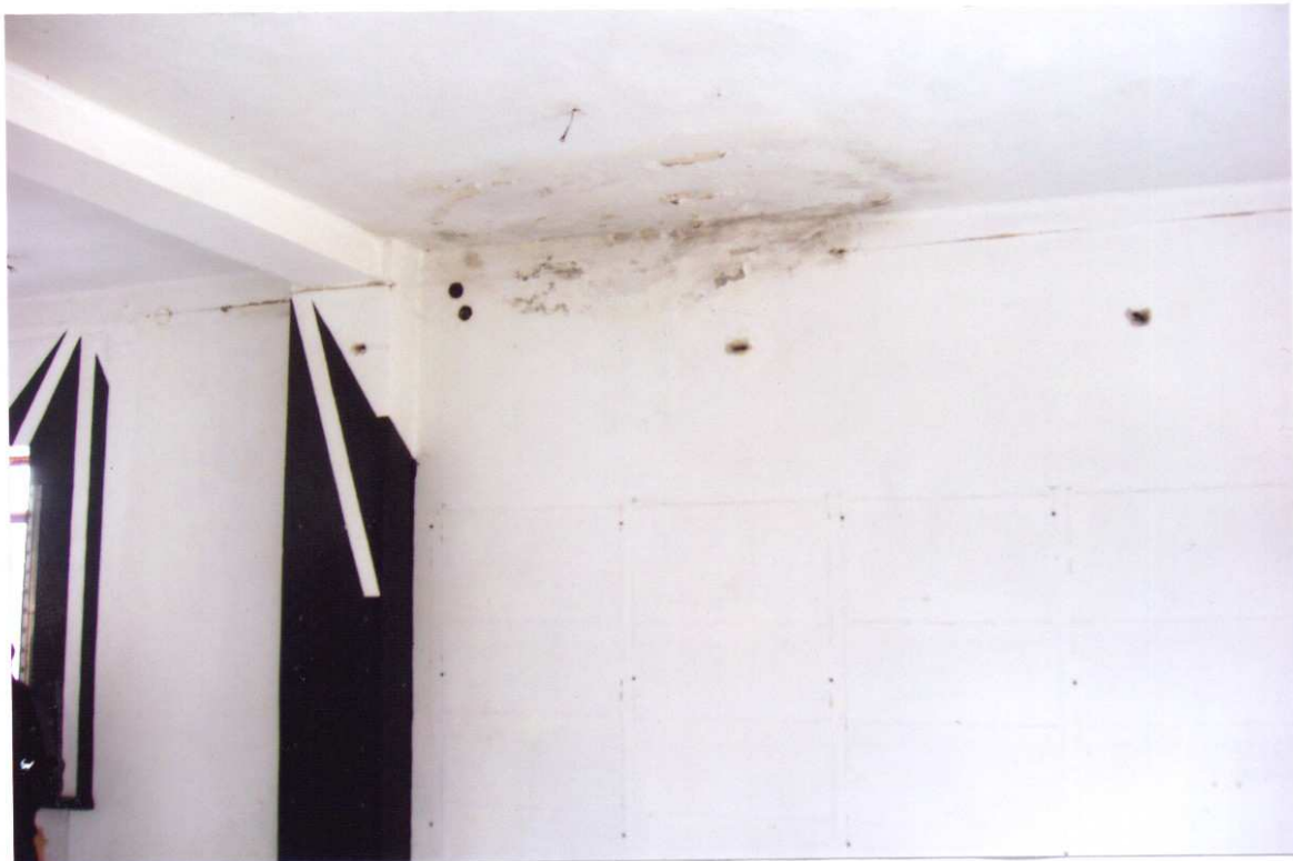
Nr 17. Zaciek na stropie sklepu na piętrze w budynku "R".
