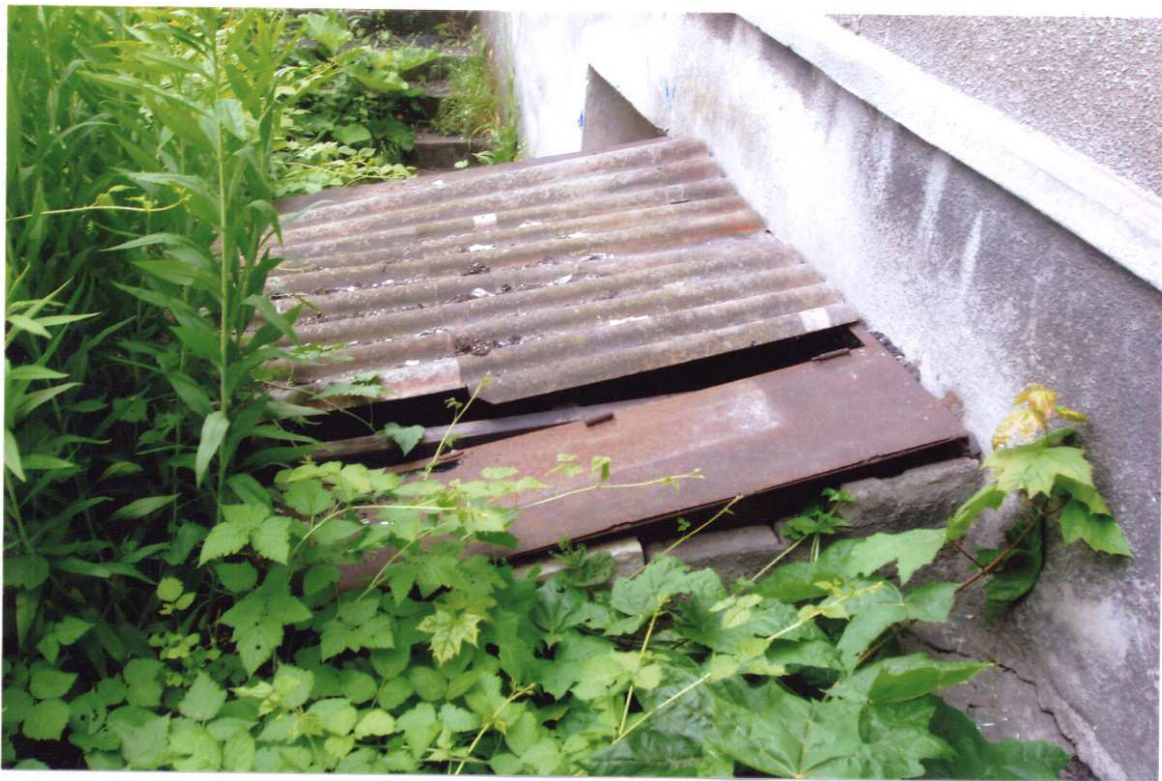
Nr 26. Widok z boku nieszczelnego nakrycia nad wyciągiem żużla z kotłowni.
