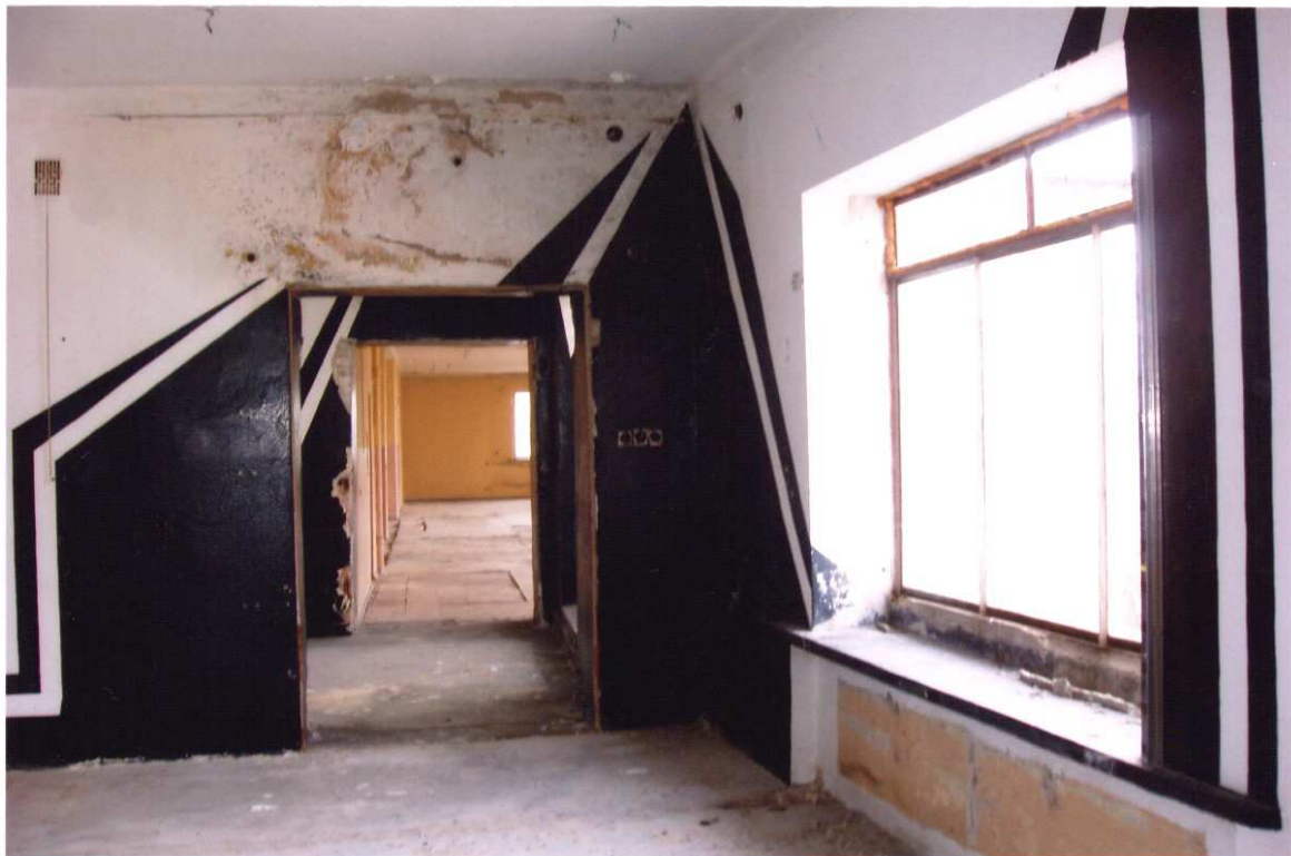
Nr 16. Widok zachodniej i północnej części sklepu na piętrze w budynku "R". Na ścianie widoczne ślady po zaciekach stropu.
